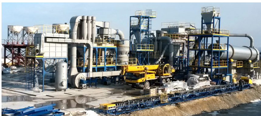
Комплекс по переработке минерального сырья, Российская Федерация
